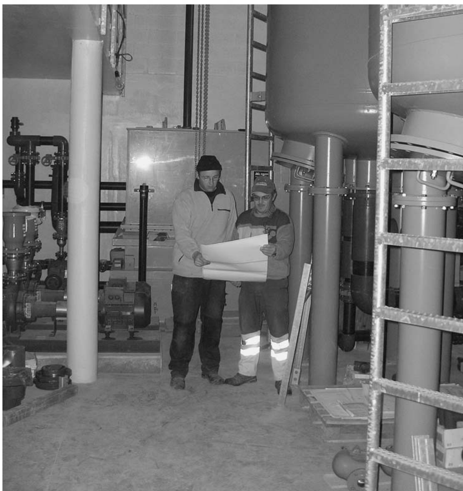
Innenansicht: Das Wasserwerk in Hepscheid geht 2006 in Betrieb
